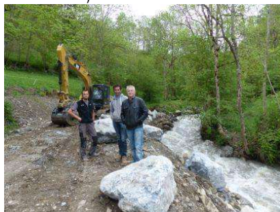
Enrochement du moulin de la Mousquère suite à la crue de 2013 (SLTS (JP. PELIEU) et Mr. Brun, Maire)
